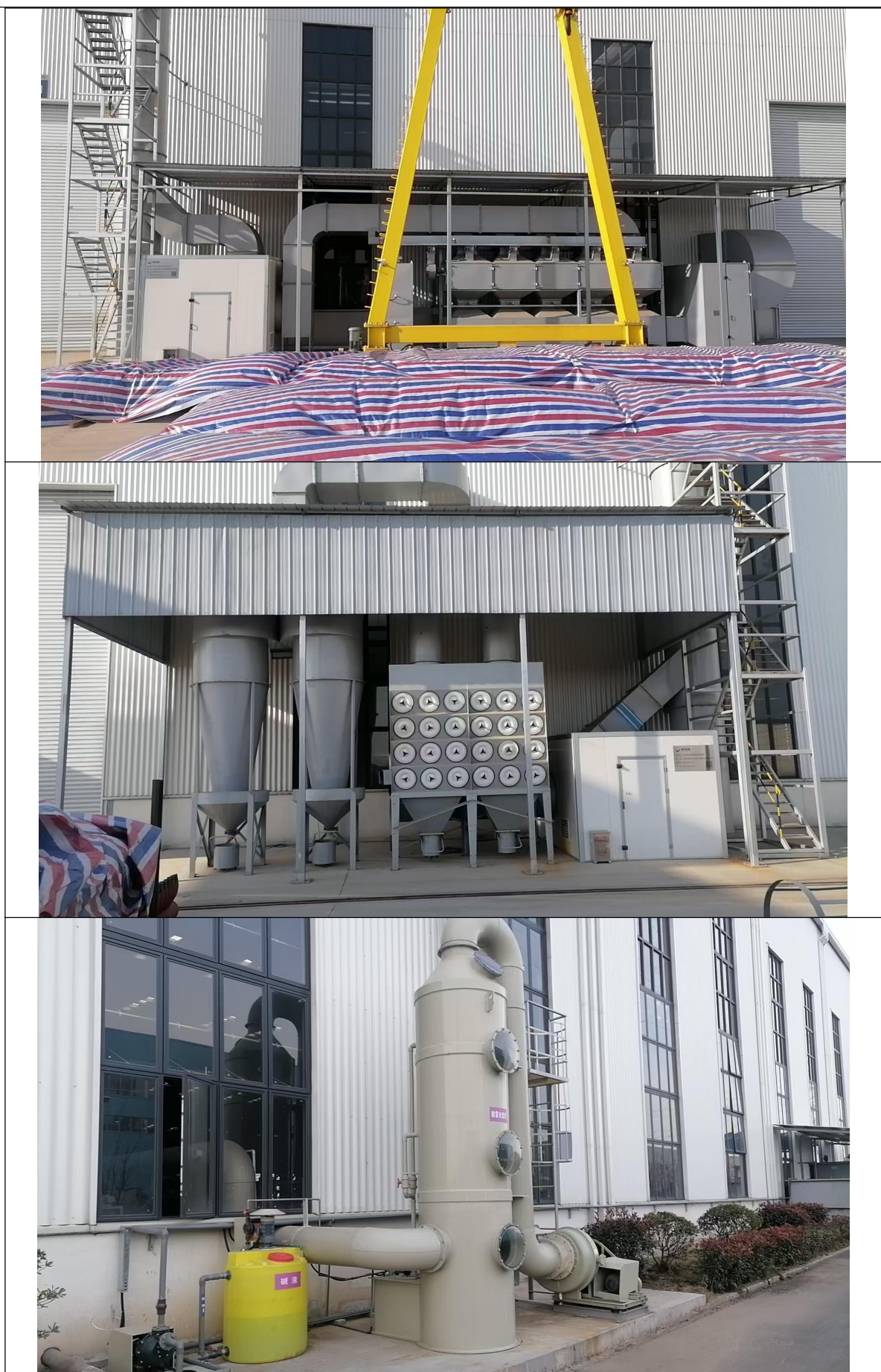
图 3-2 废气处理设施
