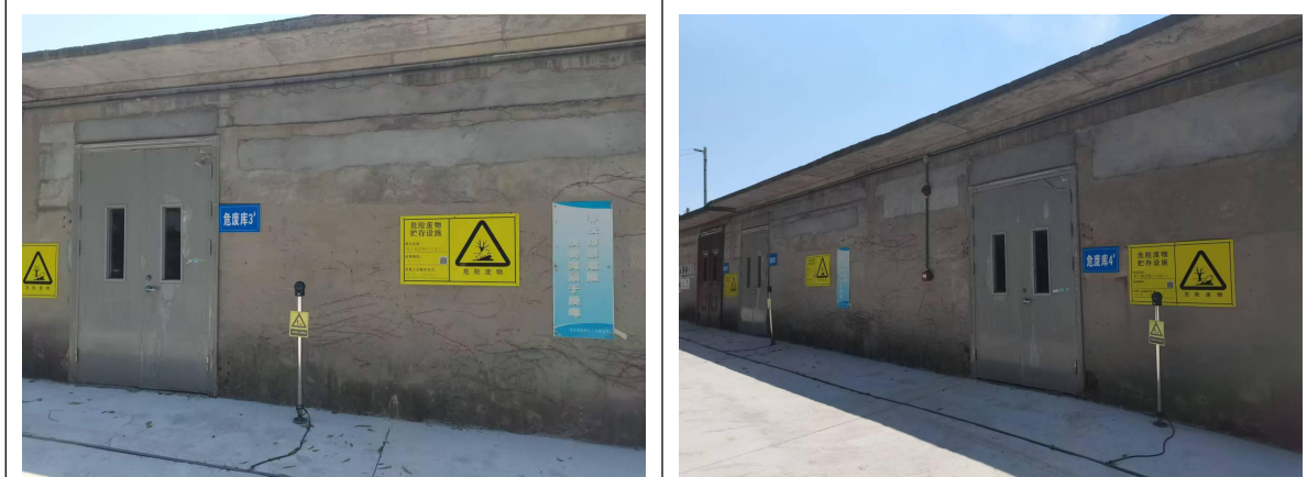
危废库危险废物标识
