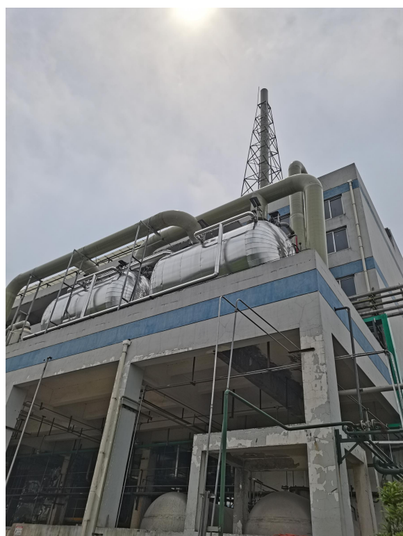
14#车间废气排放口（2#排气筒）
