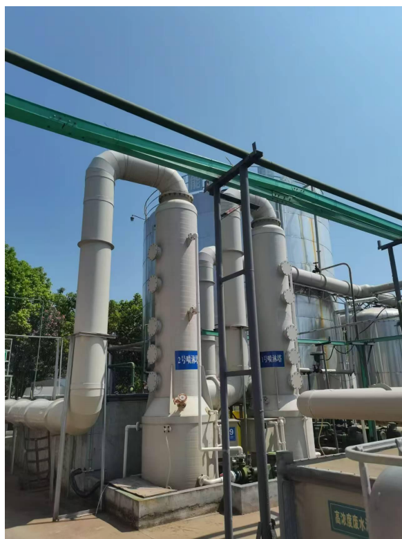
一级碱吸收+一级水喷淋
