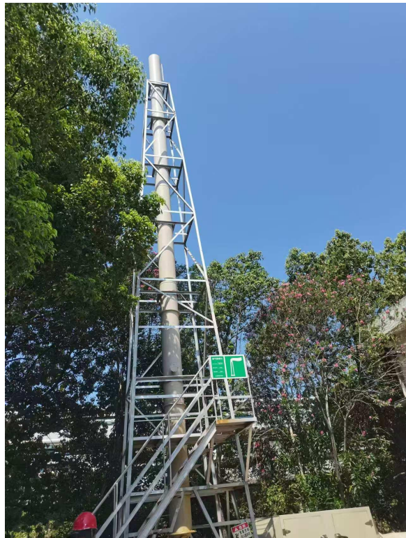
干燥车间废气排放口（3#排气筒）
