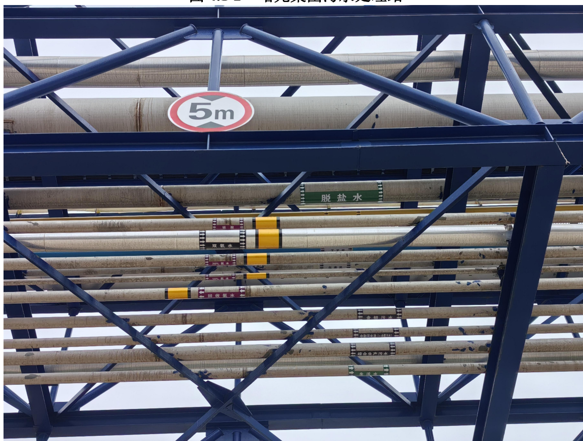
图 4.1-3 废水分类明管
