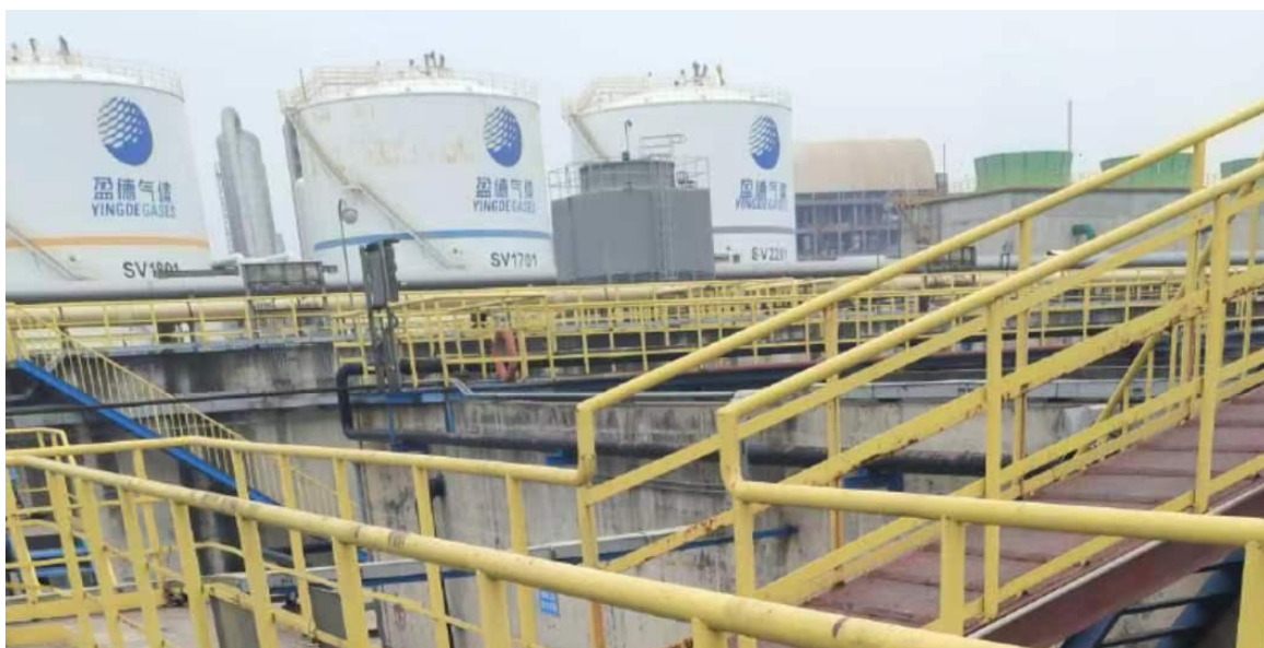
图 4.1-2 曙光集团污水处理站
