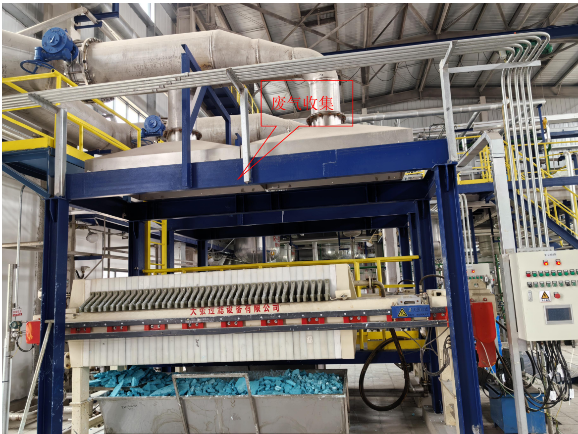
图 4.1-10 车间内废气集气罩
