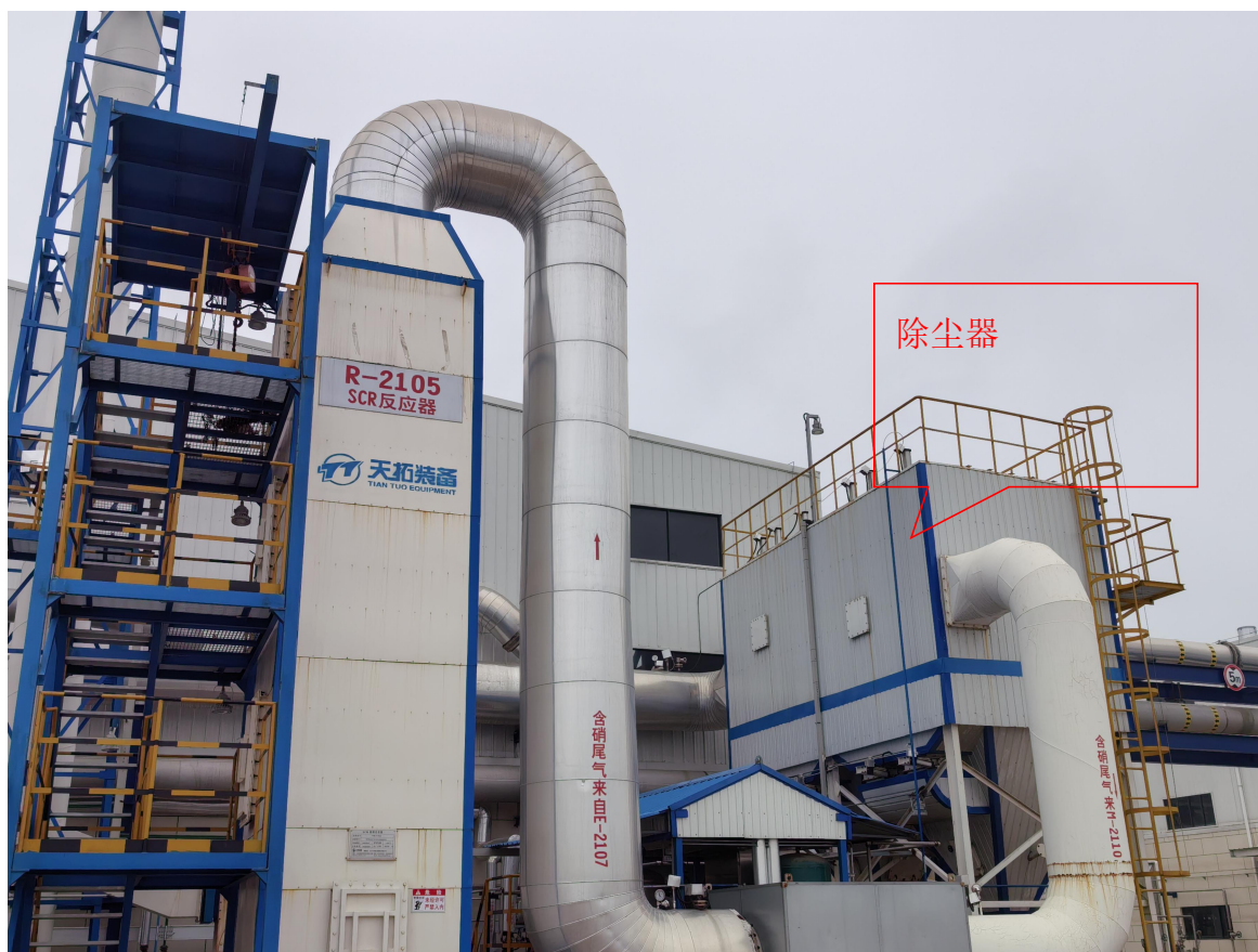
图 4.1-8 含 NO x 、含尘废气处理措施
