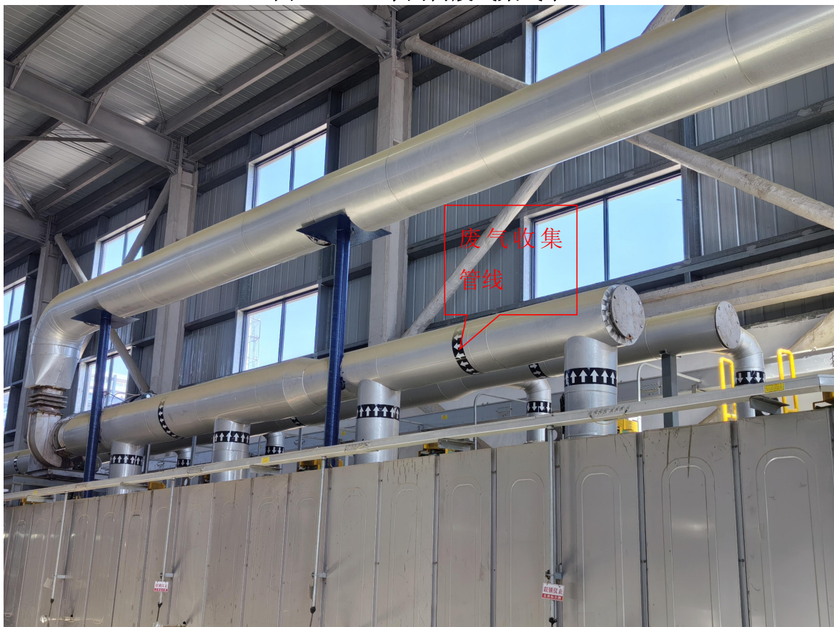
图 4.1-11 车间内废气收集管线
