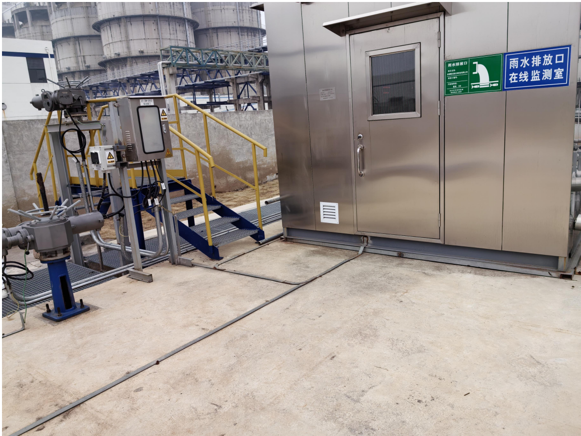
图 4.1-5 在线监测室、雨水排口
