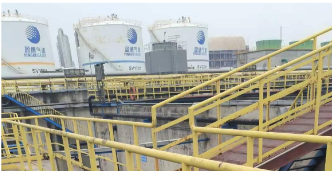
图 4.1-2 曙光集团污水处理站
