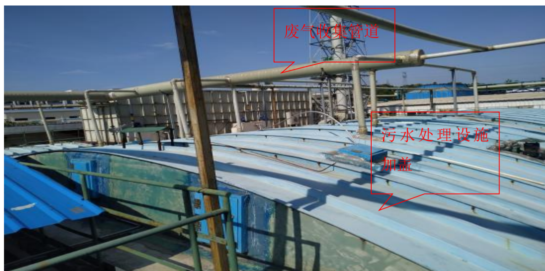
图 4.1-2 污水处理站及废气收集管道
