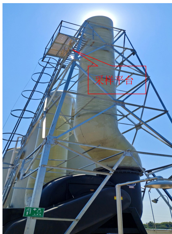
图 4.1-8 C301 车间排气筒及采样平台图
