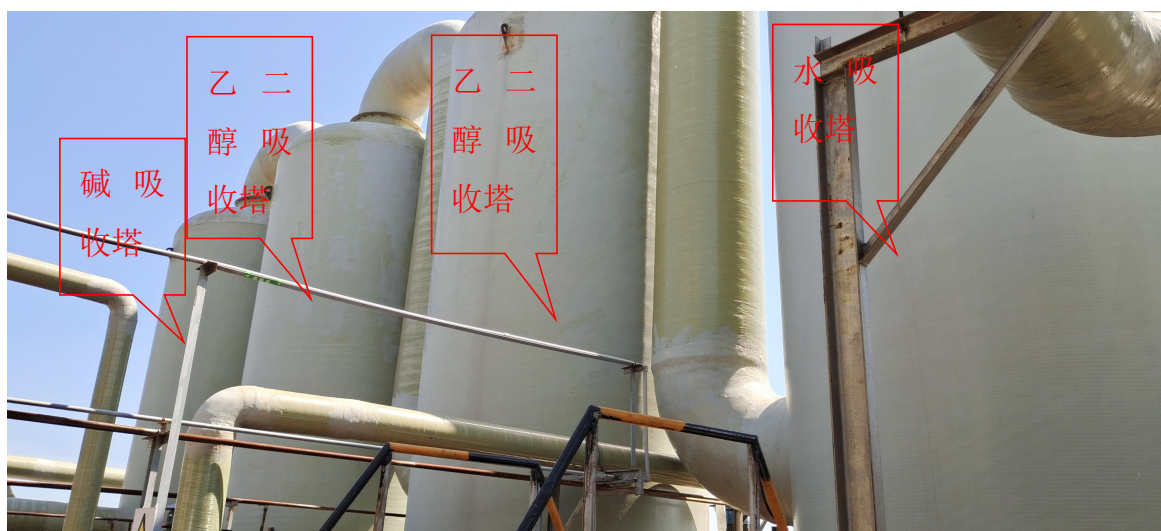
4.1-10 C302 车间后四级喷淋塔
