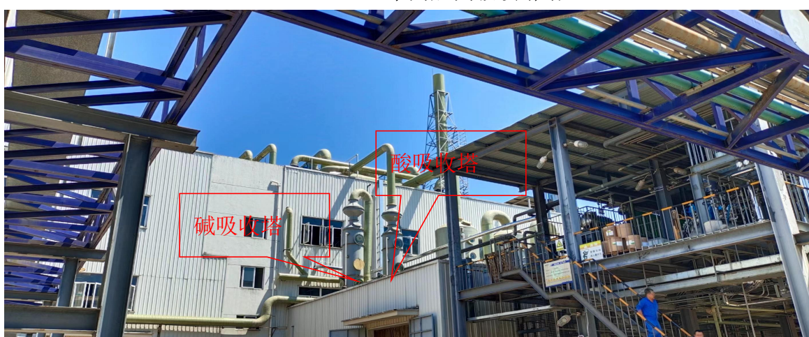
4.1-11 溶剂回收废气处理措施
