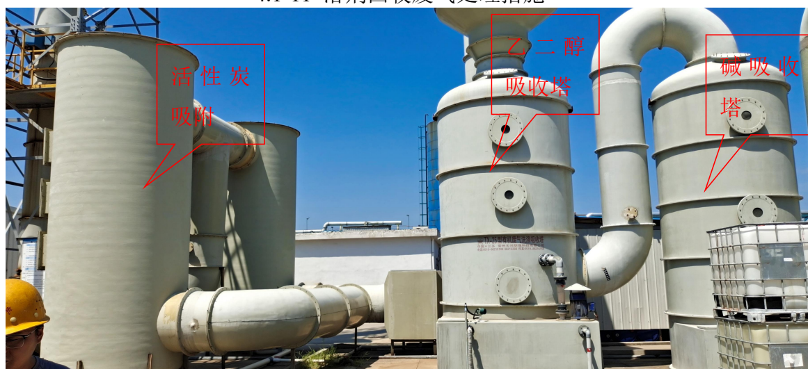
4.1-12 罐区废气处理措施
