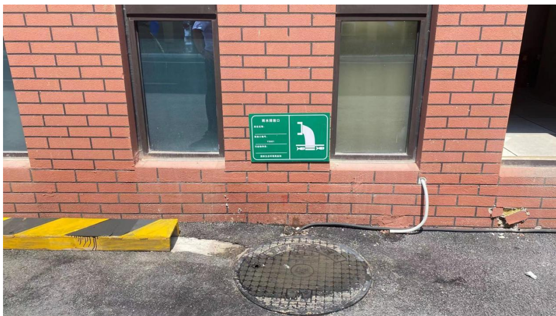
图 4.1.1-2 厂内雨水管线
