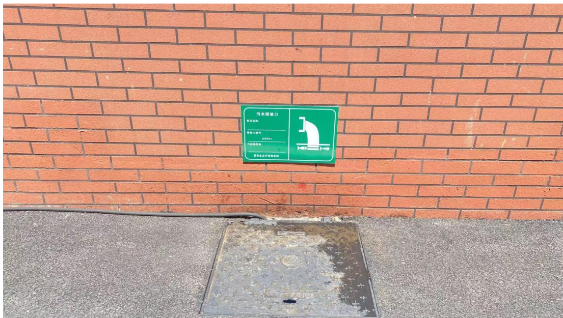
图 4.1.1-1 厂内污水管线
