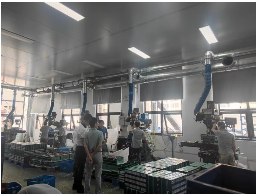
图 4.1.2-2 现场废气收集装置
