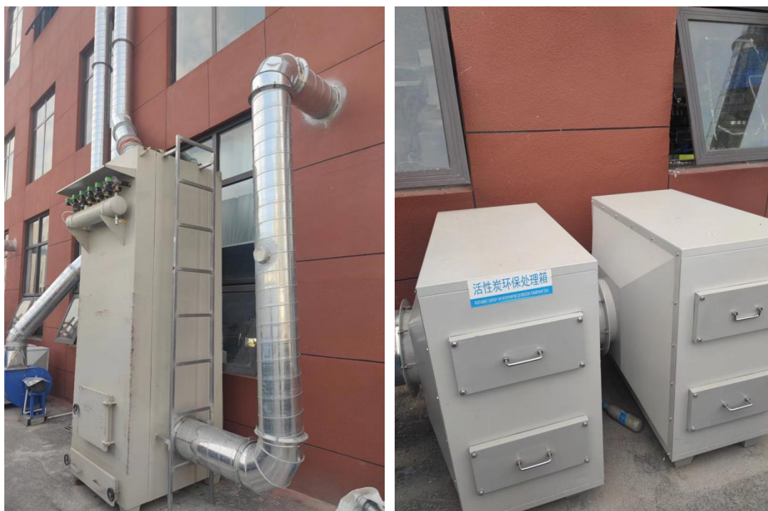
图 4.1.2-3 现场废气处理装置
