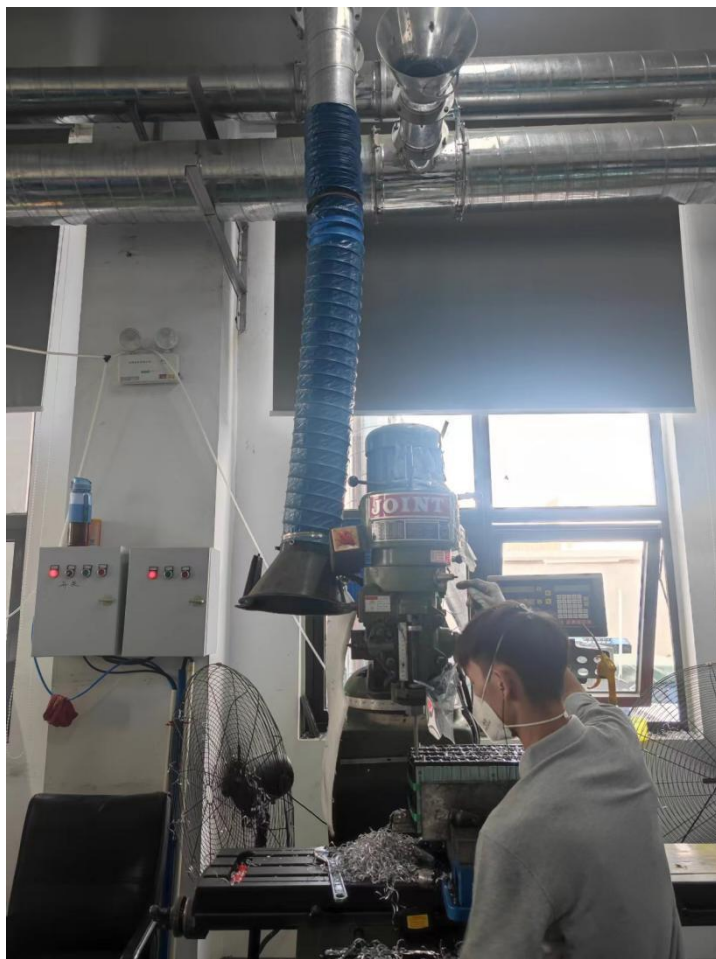
图 4.1.2-1 现场废气收集装置
