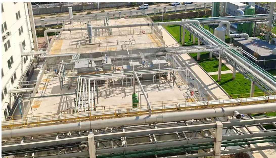
图 4.1-2 污水处理站及废气收集管道
