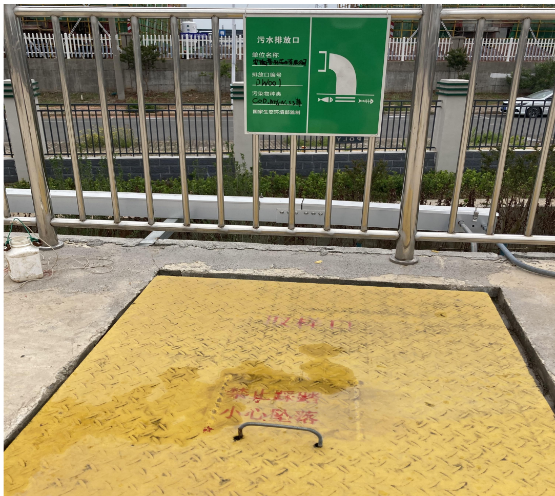
图 4.1-5 污水排放口及标志牌
