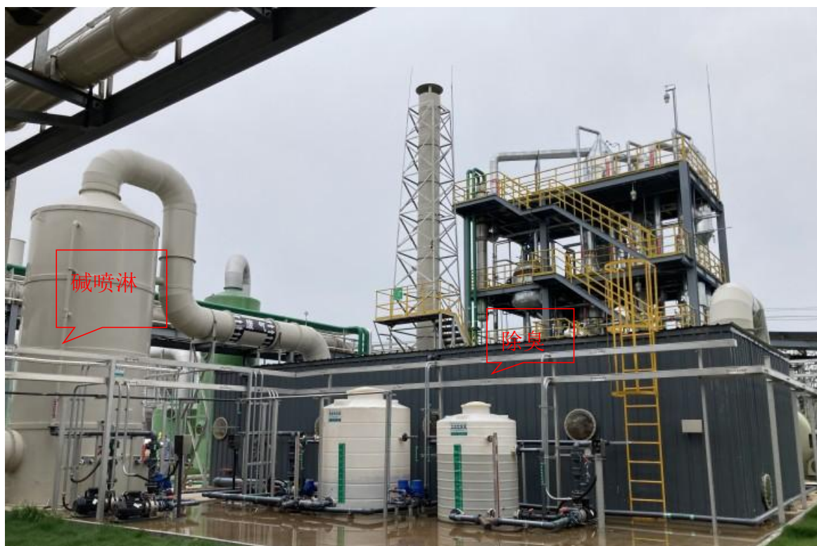
图 4.1-14 污水站、危废库、三效蒸发废气处理设施
