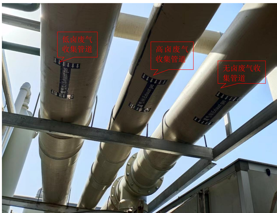
图 4.1-7 废气收集管道
