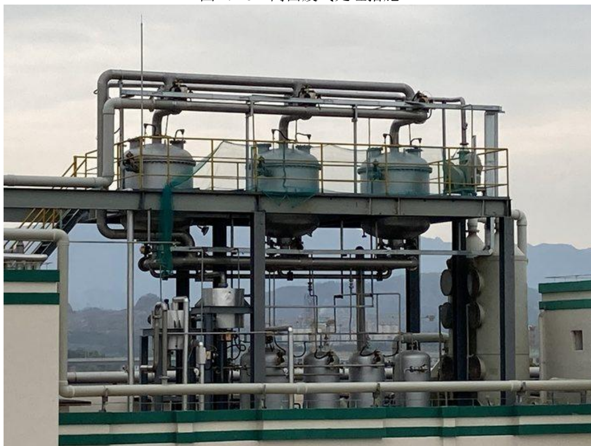
图 4.1-9 高卤废气树脂吸附装置
