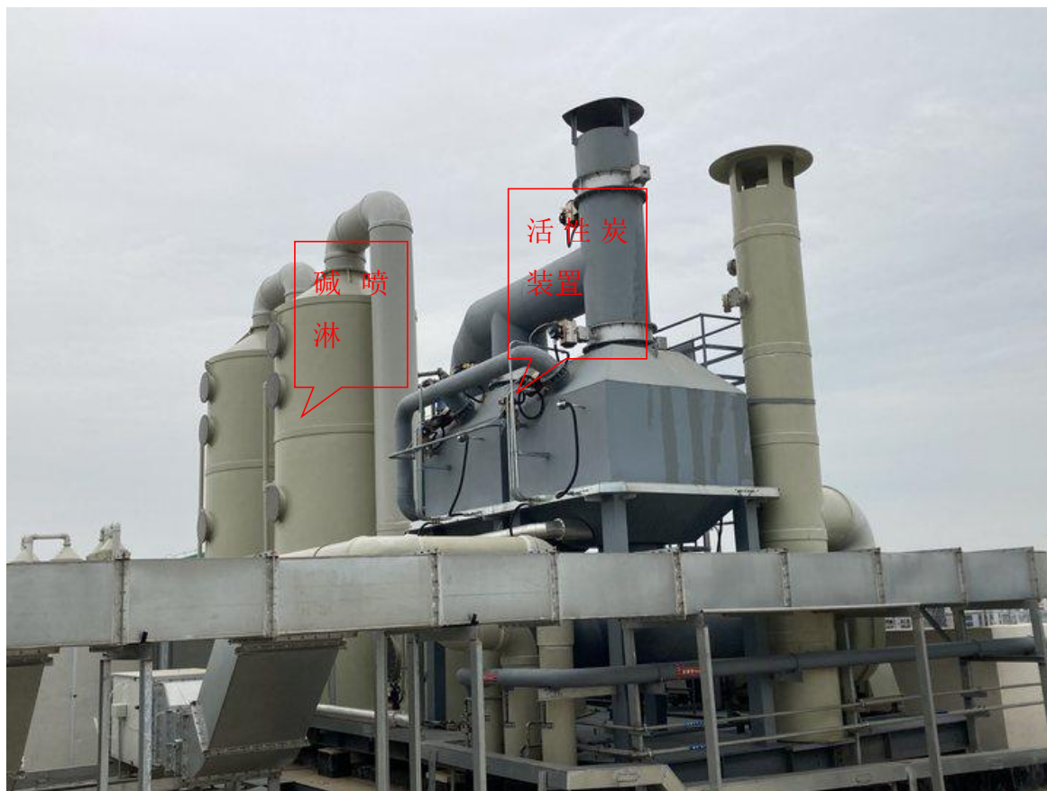
图 4.1-10 低卤废气处理措施
