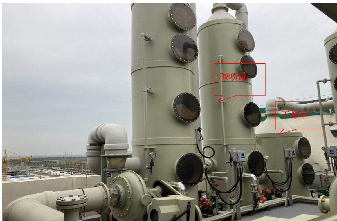
图 4.1-11 无卤废气车间预处理措施
