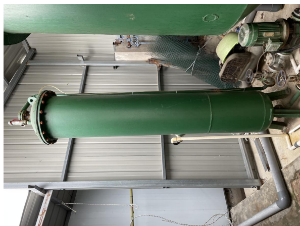
图 7-7 废水处理设施
