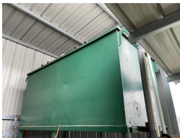
图 7-8 废水处理设施
