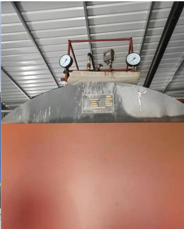
图片 7-2 蒸汽锅炉
