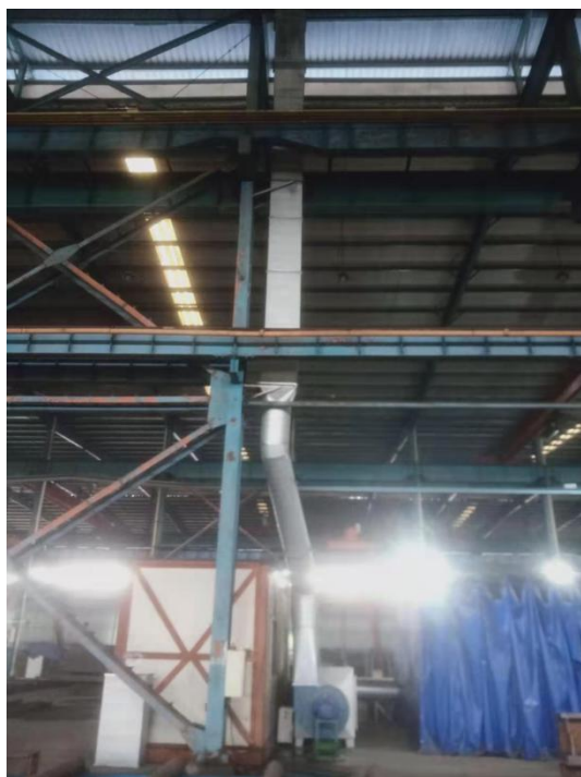
图 5 喷漆废气排气筒
