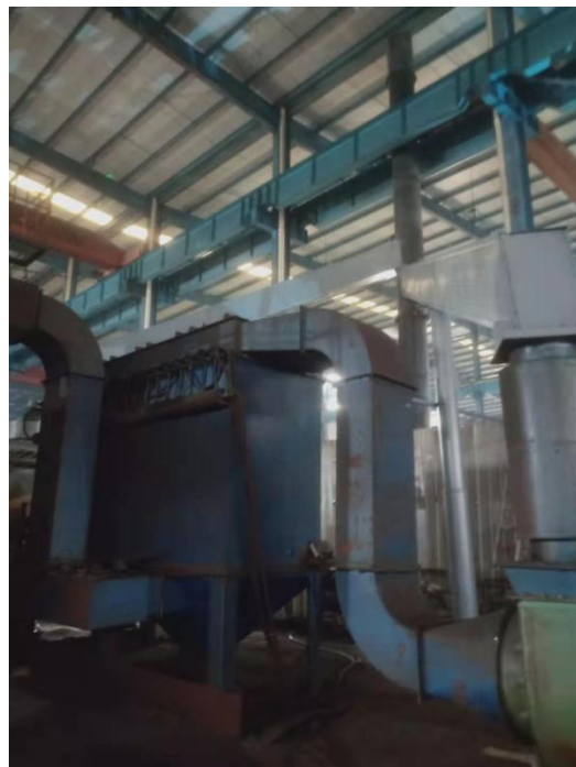
图 2 抛丸废气布袋除尘器
