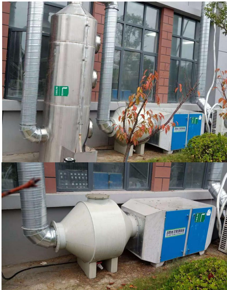
图 7-6 废气治理设施
