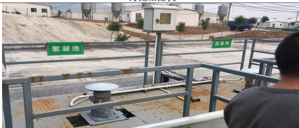
絮凝池、混凝池
