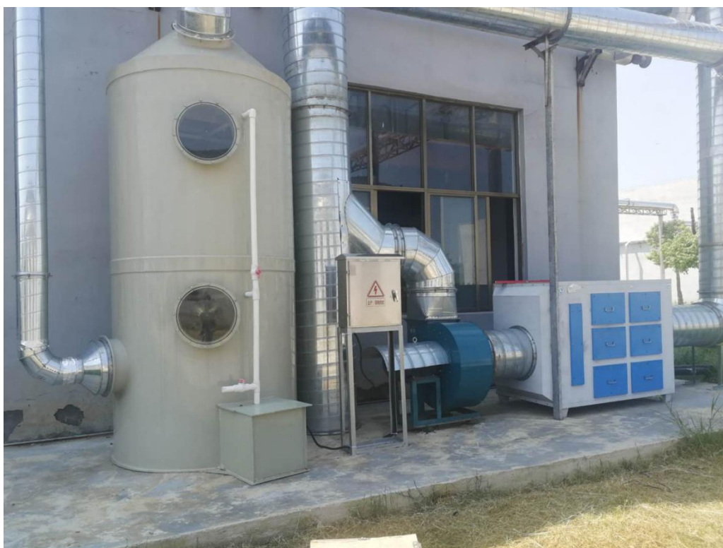
图 6-4 3#车间废气治理设施
