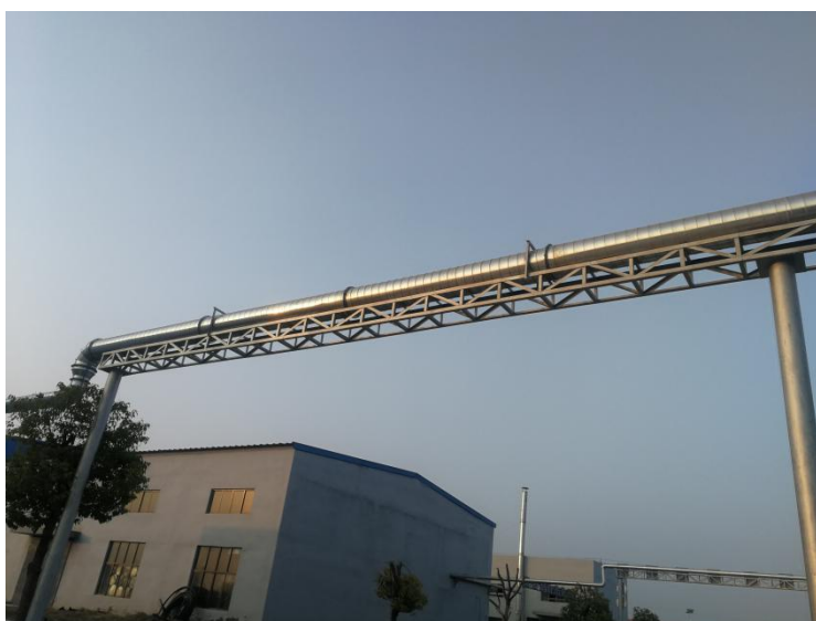
图 6-8 废气收集管道
