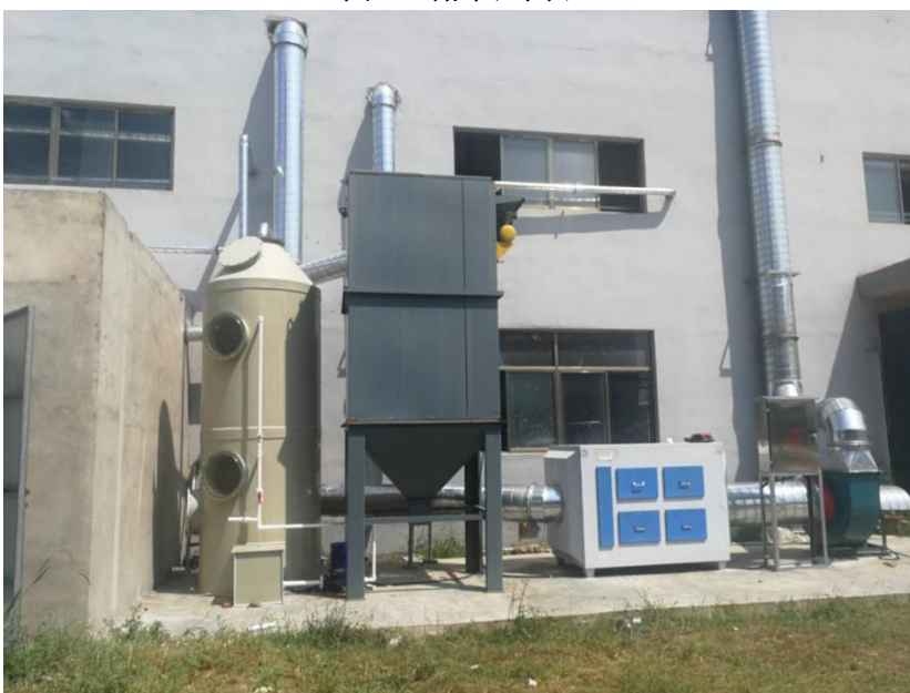
图 6-2 2#车间废气治理设施
