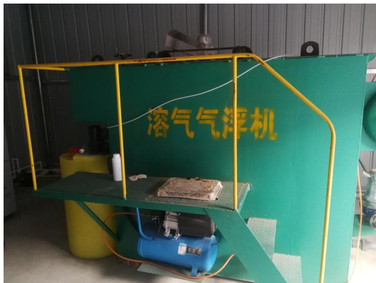
图 6-7 污水处理设施
